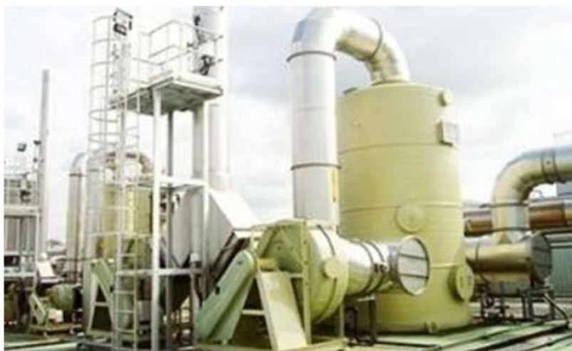
6座RTO(廢氣燃燒爐)
